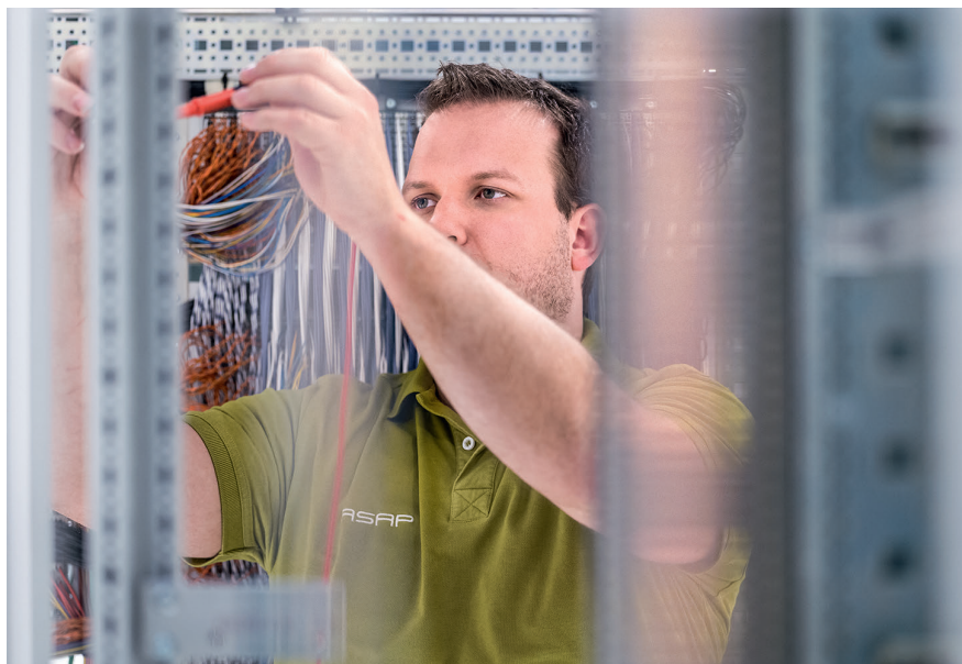
Bild 1: Verdrahtung der Kommunikationsleitungen für die Kommunikation aller Steuergeräte einer Wirkkette untereinander. © ASAP/Klaus Mellenthin
